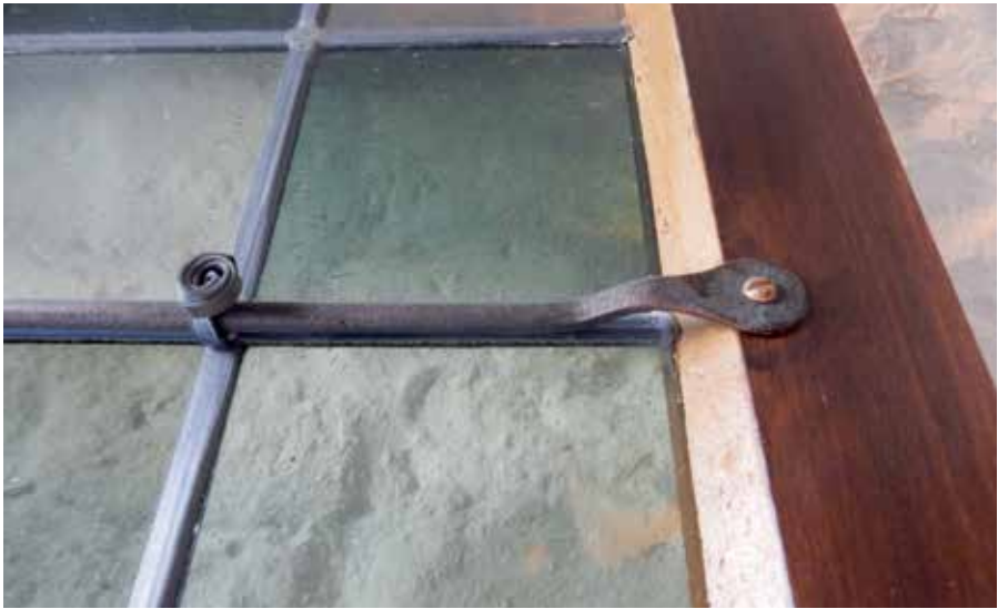
De ijzeren windroeden waren te zeer aangetast door corrosie en zijn daarom nagemaakt in koper.
